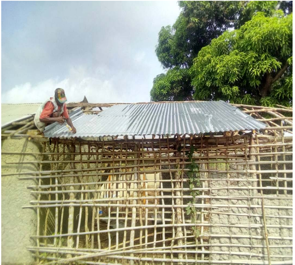
Nytt tak legges. Nye vegger er klargjort for å fylles med sementblanding.
